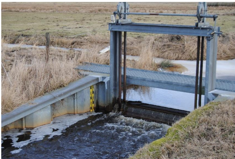
Abb. 2: Doppelschützenanlage zur Regulierung der Grabenwasserstände. Über die Kurbel kann die Stautafel rauf oder runter gestellt werden, um den Wasserstand einzustellen.
