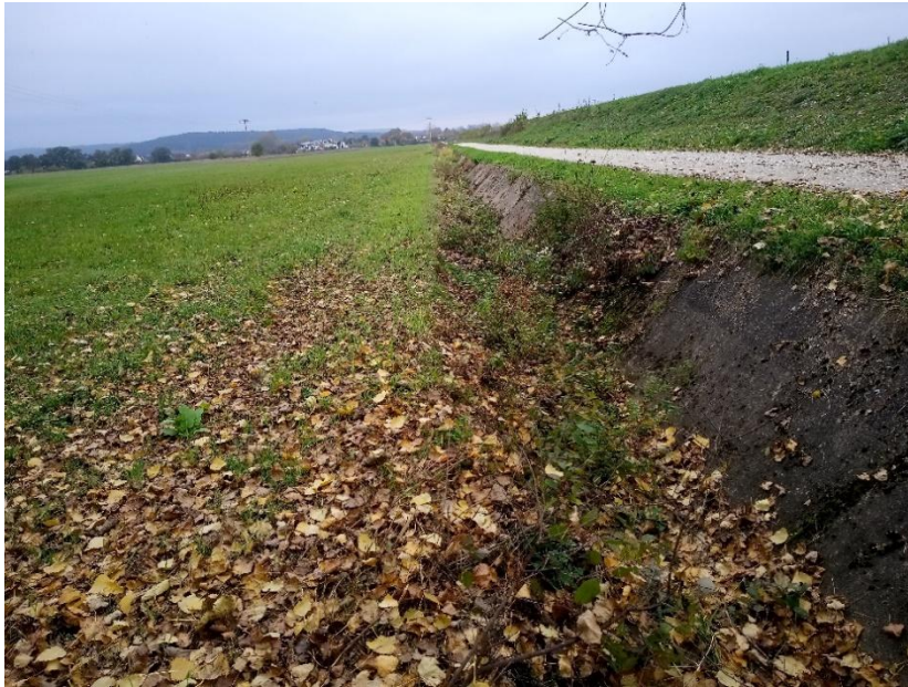
Abb. 4: Im Bewässerungsgraben (rechts im Bild) hat sich inzwischen viel Sediment abgelagert, weshalb der Betonuntergrund gar nicht mehr zu sehen ist. Rechts vom Graben befindet sich der Kanal. Bei Einstau bewässert der Graben die Wiese links im Bild. Foto: Anton Hofmann
