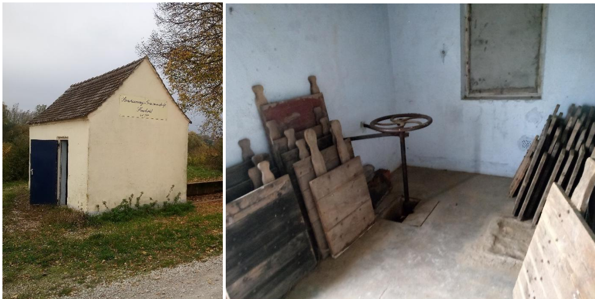
Abb. 2: In dem kleinen Häuschen (links) befinden sich die beiden Schieber zum Öffnen und Schließen der Einlassrohre. Die Bedienung der Schieber erfolgt durch Drehen der Handkurbel. Foto: Anton Hofmann
