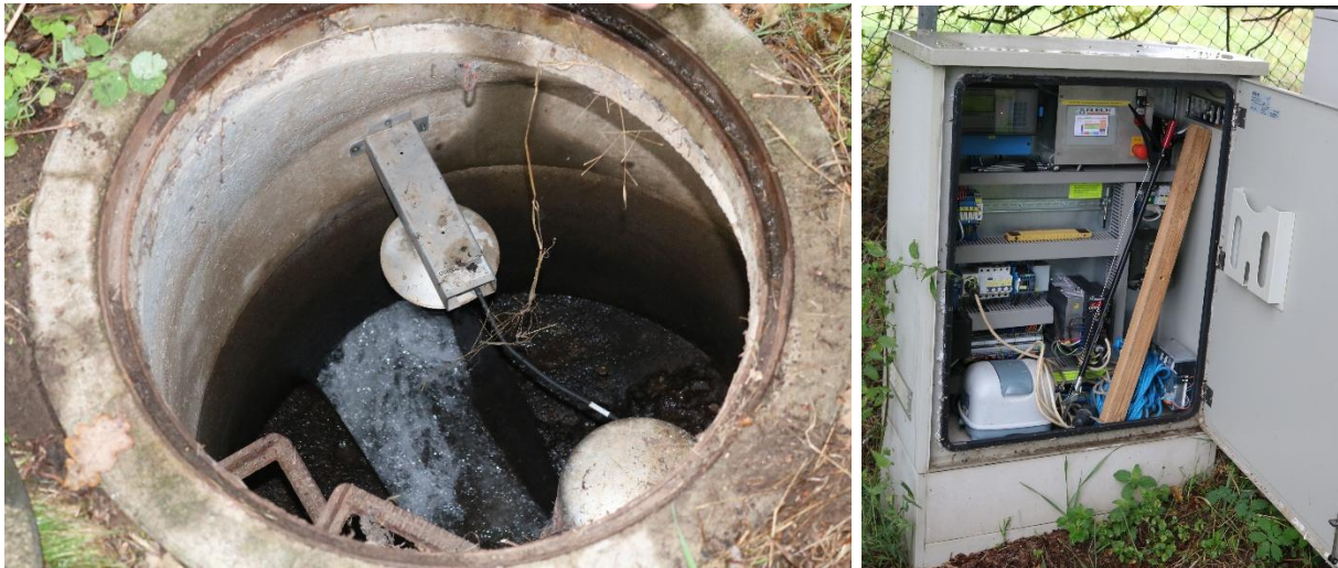
Abb. 4: Ein Sensor misst die Durchflussmenge des Wassers (links). Diese wird dann mit der Soll-Durchflussmenge verglichen. Gelangt zum Beispiel mehr Wasser ins Grabensystem als es soll, verringert das System im Schaltkasten (rechts) in Verbindung mit dem Motorschieber im Betonschacht automatisch den Durchfluss. Fotos: Thomas Köhler
